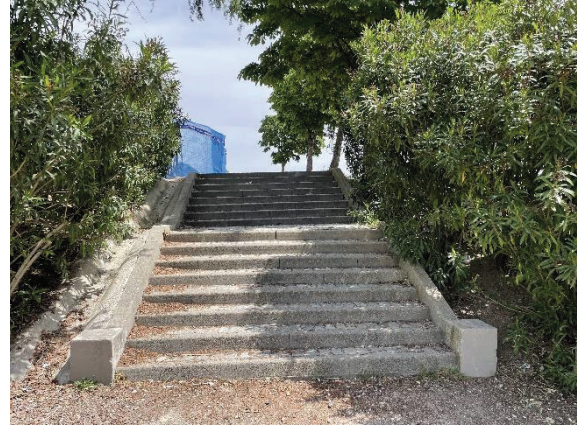
Una de las escaleras entre ambas explanadas, desprovista de barandillas y pasamanos
