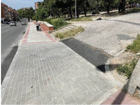
Acceso desde Ctra. Canillas con problemas de accesibilidad
