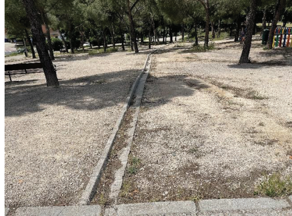
Cárcavas junto al bordillo rigola en el pinar sur
