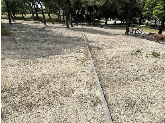
Bordillo rigola enterrado por arrastre de materiales
